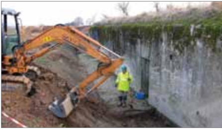
Geispolsheim (Bas-Rhin) : position fortifiée allemande en cours de fouille © Photo M. Landolt, Pair
