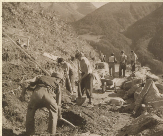
Ardez (GR) Camp du service de travail d'été des étudiants. Construction d'une route.
